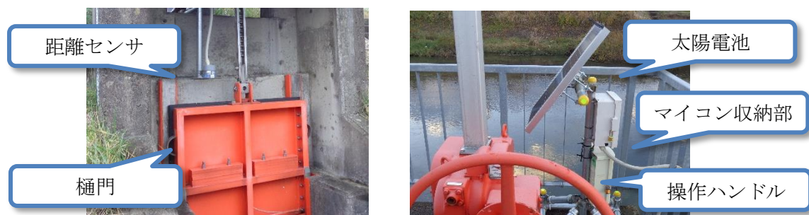
図2 システムの設置状況（左：距離測定部、右：電源およびマイコン設置部）
