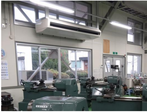
写真 整備改修による工場用大型空調
